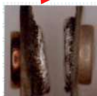
消耗所致 接触不良
